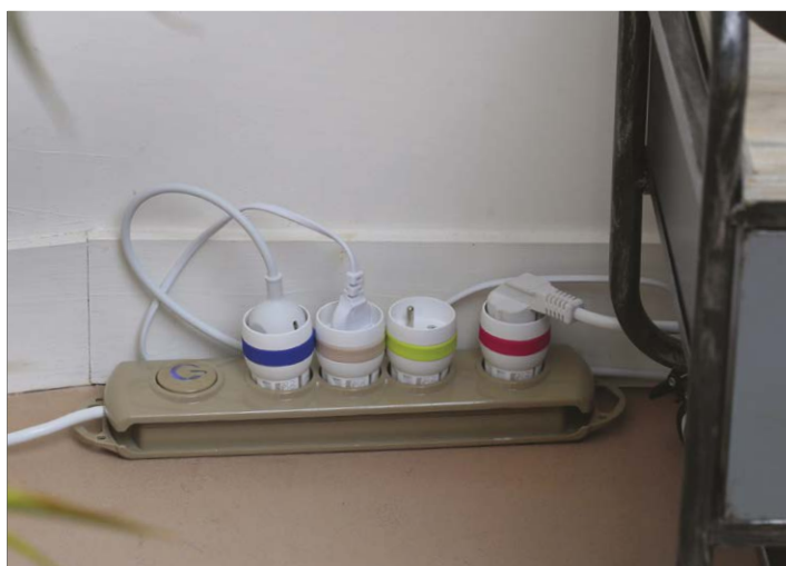
Coupe automatique de l'alimentation des équipements multimédia la nuit*
